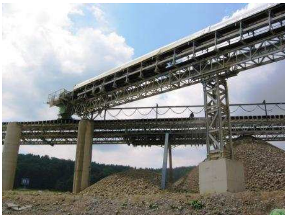
Übergabestelle von einem zum anderen Förderband
