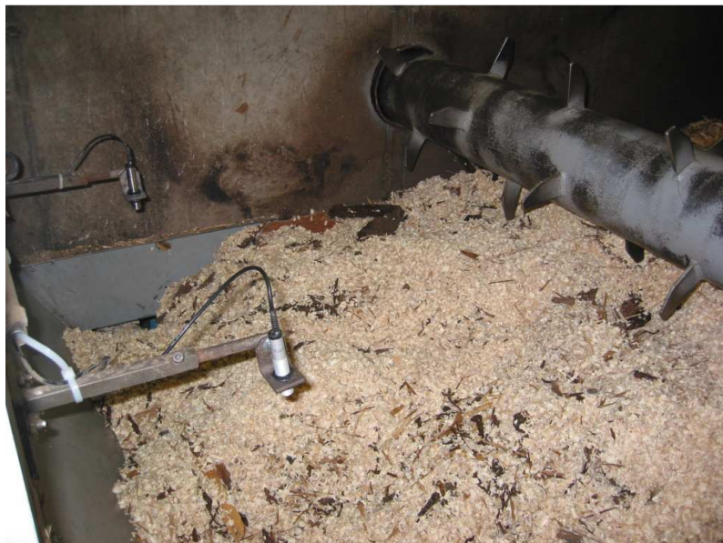
2 Ultraschallsensoren über einem Holzschnitzel-Förderband
